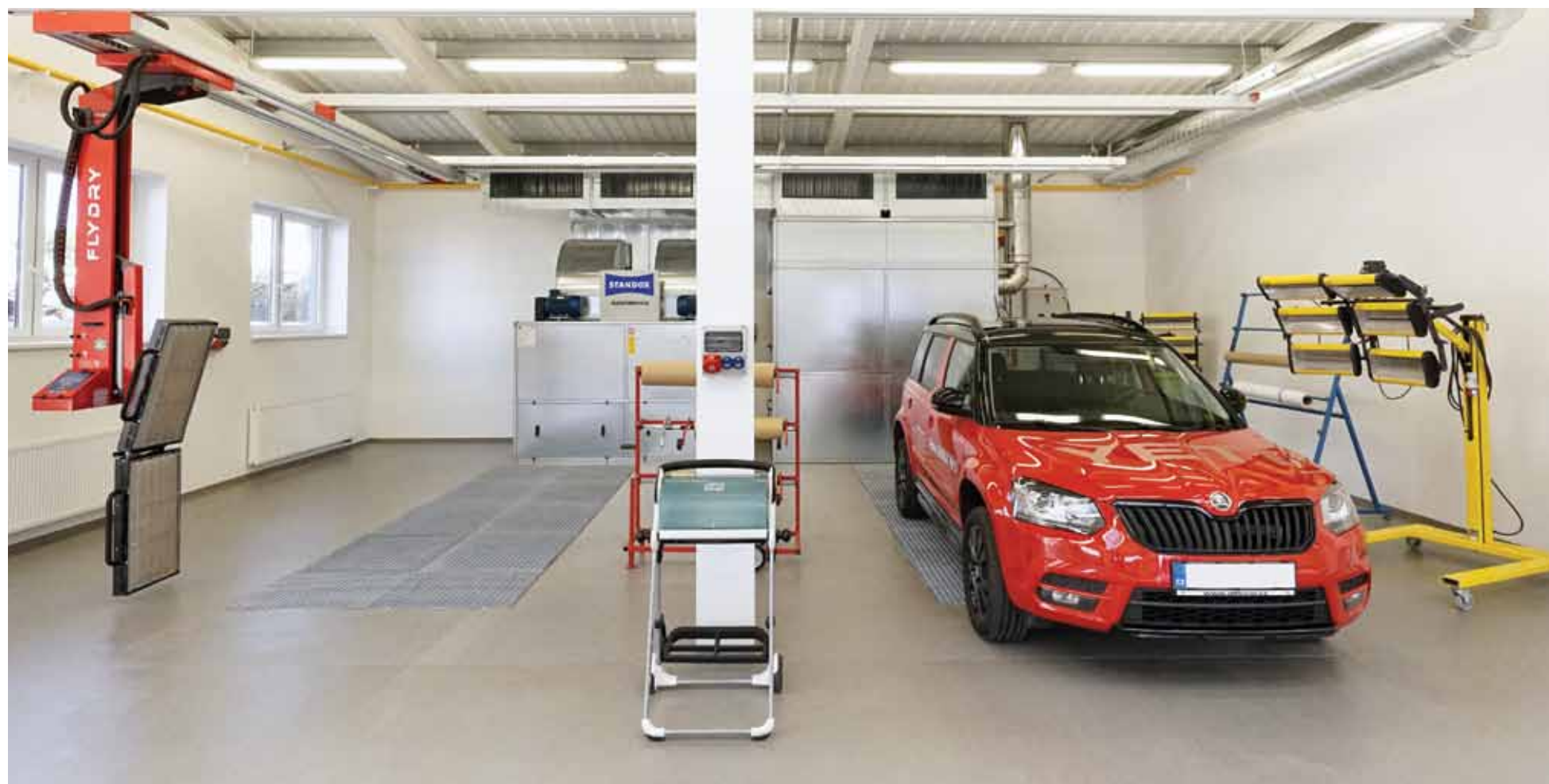
Přípravné stání osazené dvěma výkonnými zemními odsávacími kanály, technologií umístěnou za pracovištěm a sušícím robotem Symach Flydry
